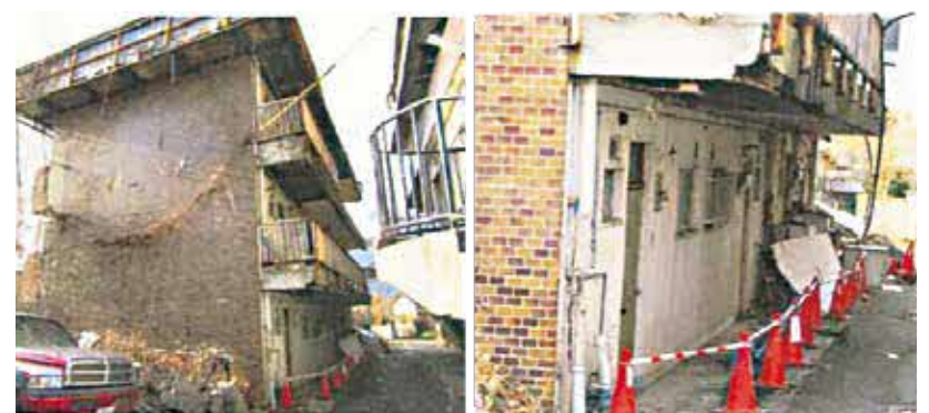
▲外壁と手すりが崩落している
